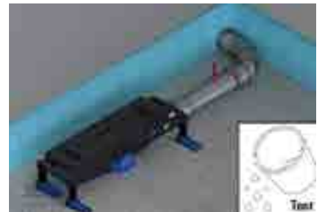
3. Odvodni priključak, na jedno od tri moguća mesta, povezati na odvodnu instalaciju i na zaptivenost ispitati.
